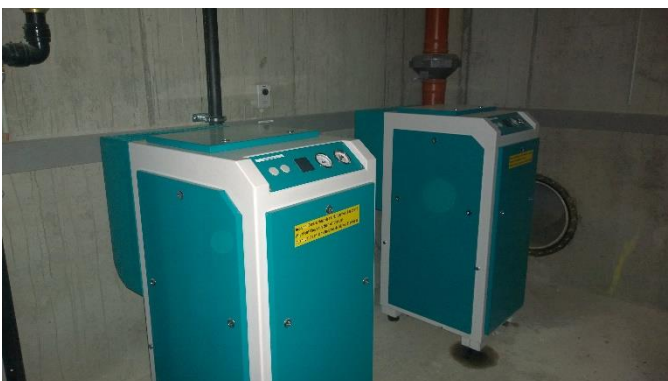
Mittels modernster Technik werden unsere Abwässer nach VG gepumpt
